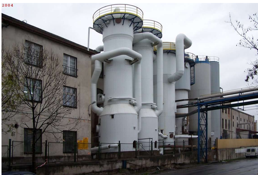
Rysunek 1 Zmodernizowana w 2004 roku stacja wyparna cukrowni Cerkiew.
